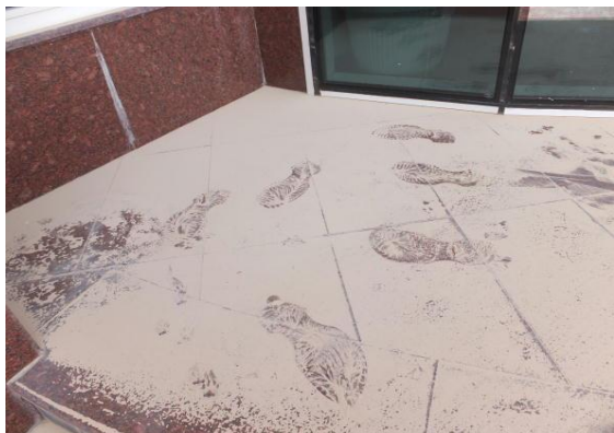
玄関前に砂塵が吹きだまった状況（ドーハ市内）
